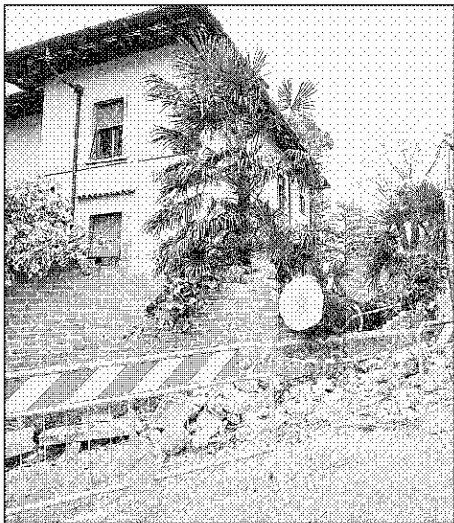
Cividale: il muro crollato a causa dell'albero sradicato dalla furia del vento (Foto Anteprima)
