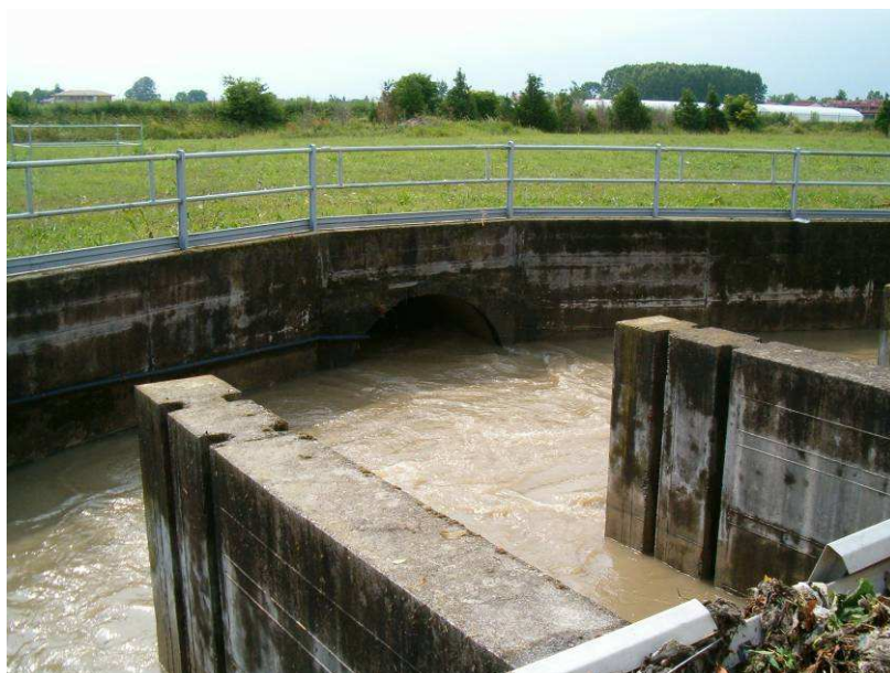
Manufatto di sollevamento nel Canale Fossalon della rete fognaria comunale a Paludo di Latisana (portata 8 mc/s)
